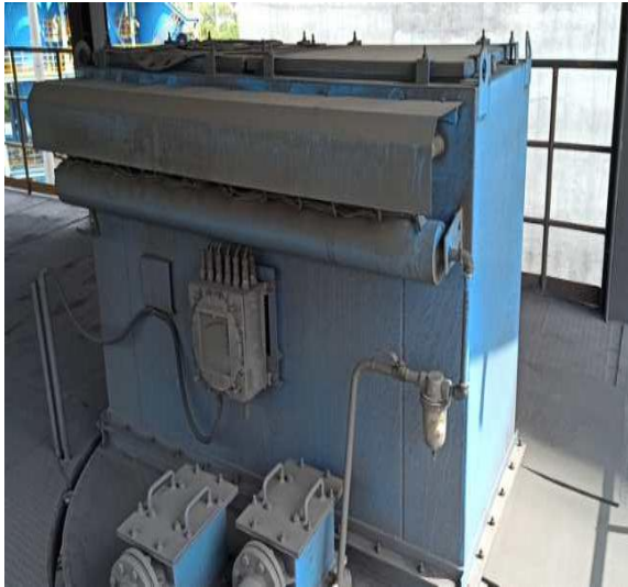
焦粉罐小型布袋除尘器
