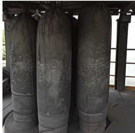
焦粉罐小型布袋除尘器
