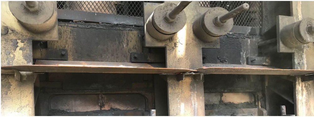
挡烟板（碳化室机侧炉柱上方与托架下方）
