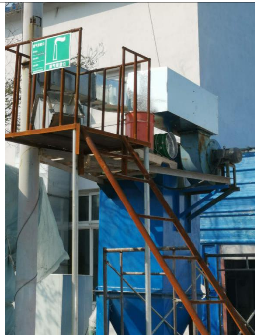
1 车间除尘器+活性炭吸附装置
