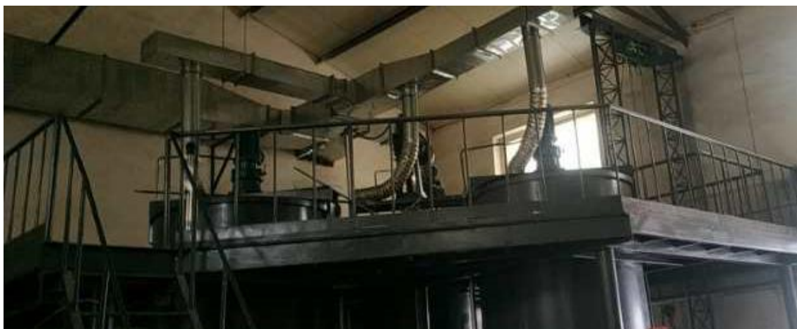
2 车间集气管道
