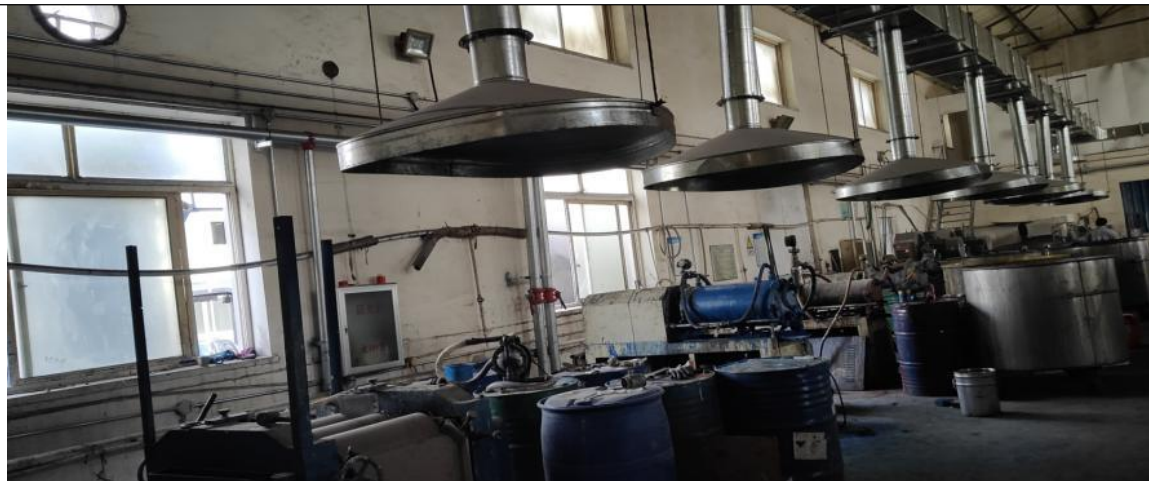
1 车间集气罩+集气管道
