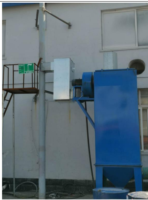
2 车间除尘器+活性炭吸附装置
